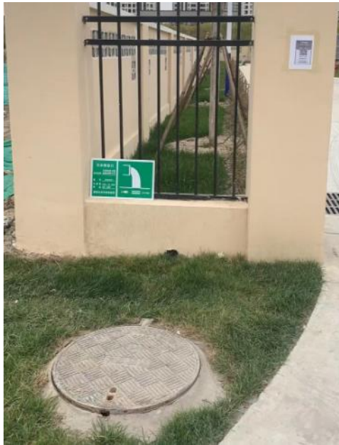
图 7-2 本项目污水总排口规范化照片
