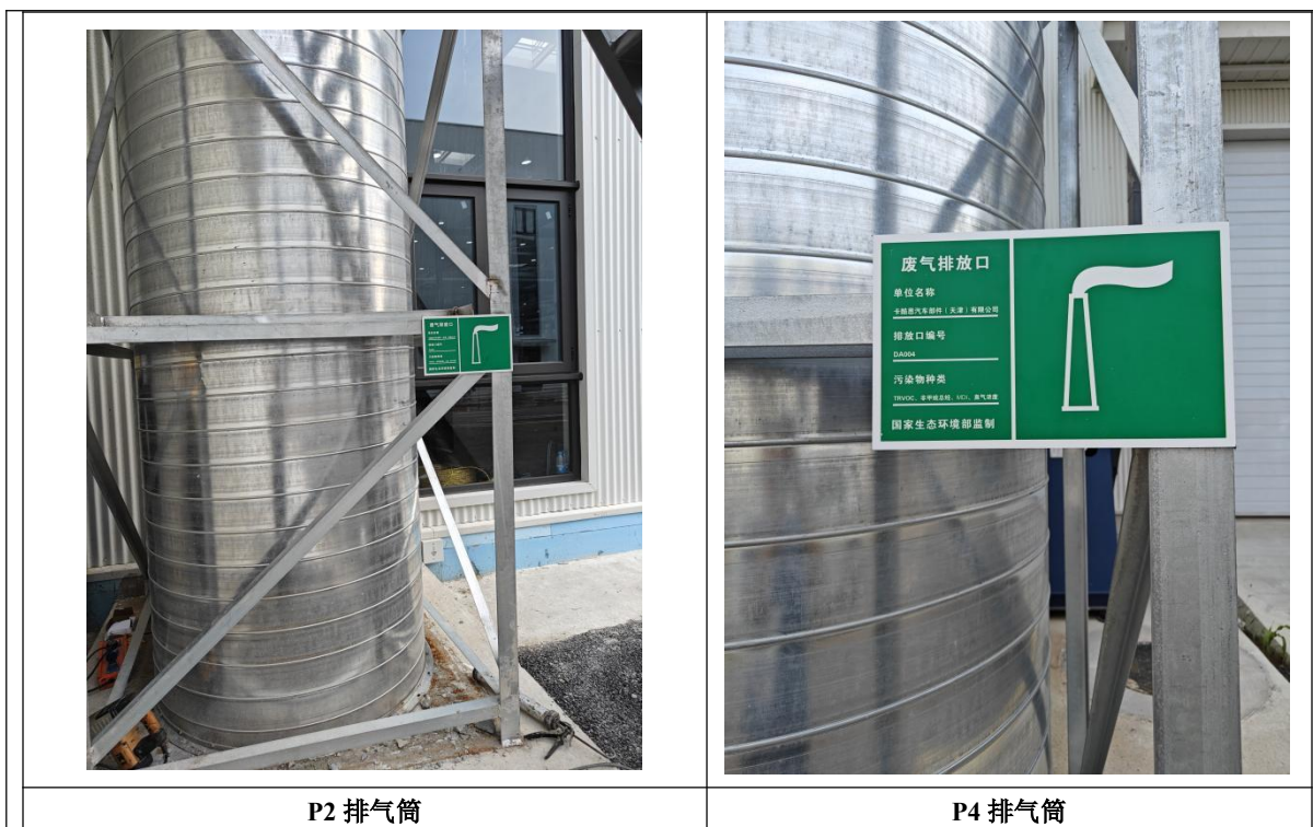
图 3-1 废气收集治理设施及排气筒
