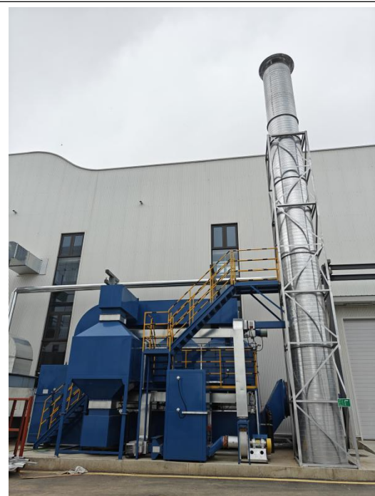
发泡工序催化燃烧装置
