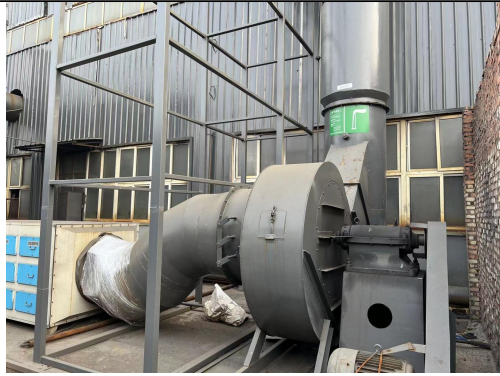
排气筒 DA007 (浇注废气 P14)
