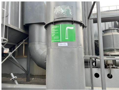
排气筒 DA005 (AMF 落砂 P4)
