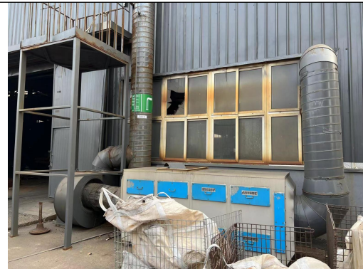
排气筒 DA006 (制芯废气 P13)
