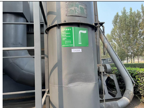
排气筒 DA004 (砂处理工序 P5)
