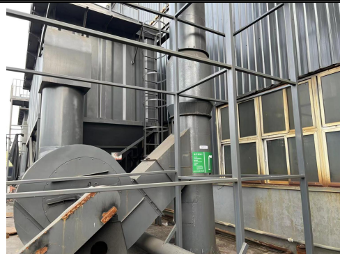
排气筒 DA010 (树脂砂造型废气)
