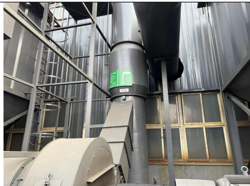
排气筒 DA003 (旧砂再生废气 P3)
