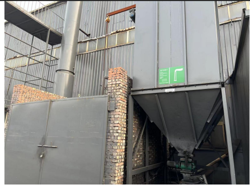
排气筒 DA008 (树脂砂落砂废气 P1)
