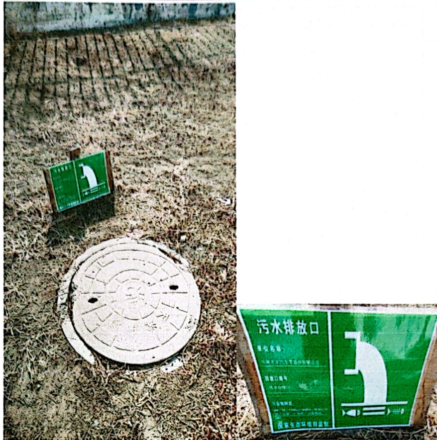
污水排放口及标识牌
