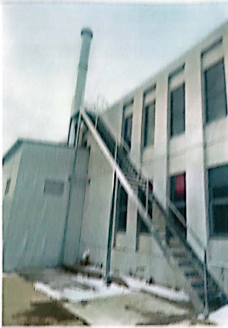
排气筒、采样平台照片
