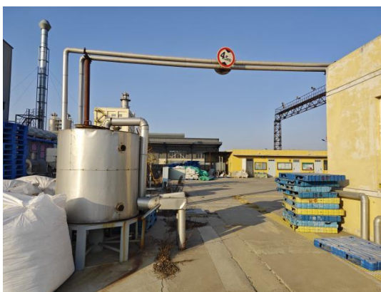
防冻液罐（输送管线）
