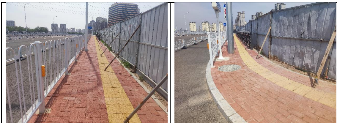
人行道透水砖铺装
