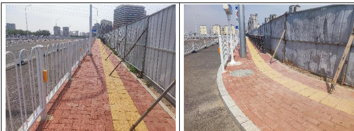
人行道透水砖铺装
