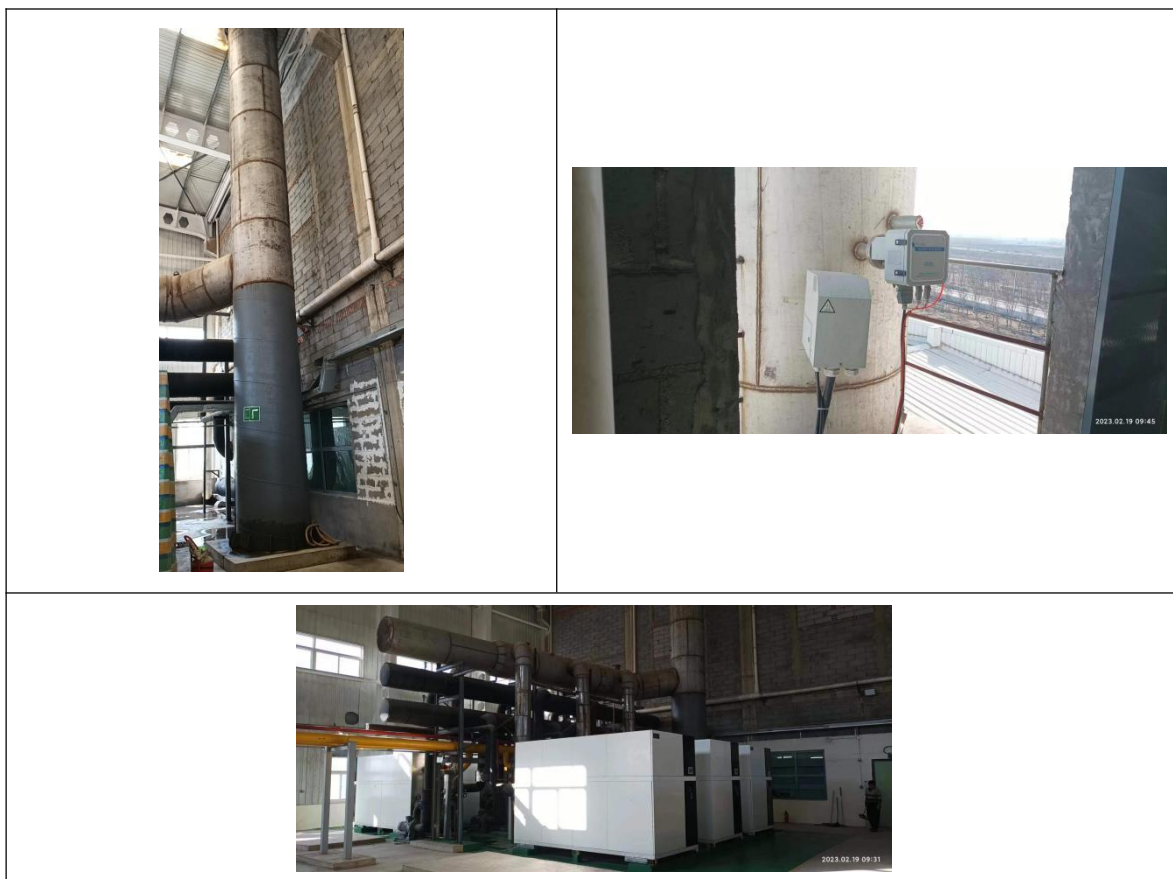
图 3-1 燃气锅炉排气筒 P1 及其在线监测
