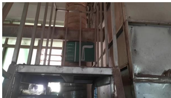
排气筒P2标识牌
