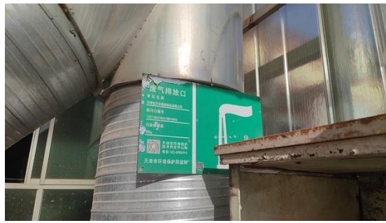
排气筒P1标识牌
