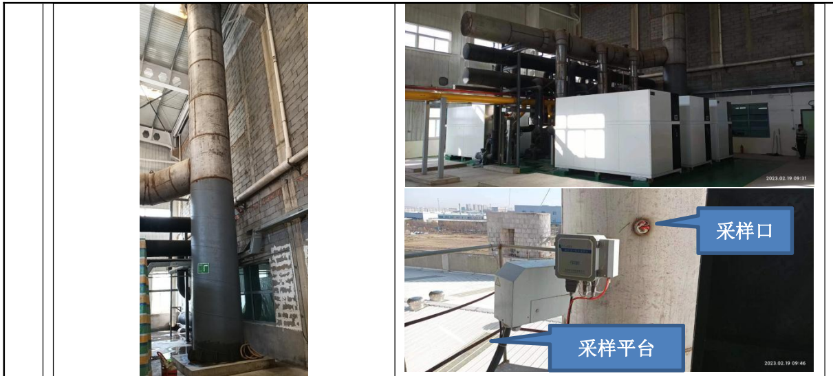
燃气锅炉排气筒 P1
