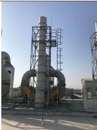
废气排放口 P31（碱性气体洗涤塔）
