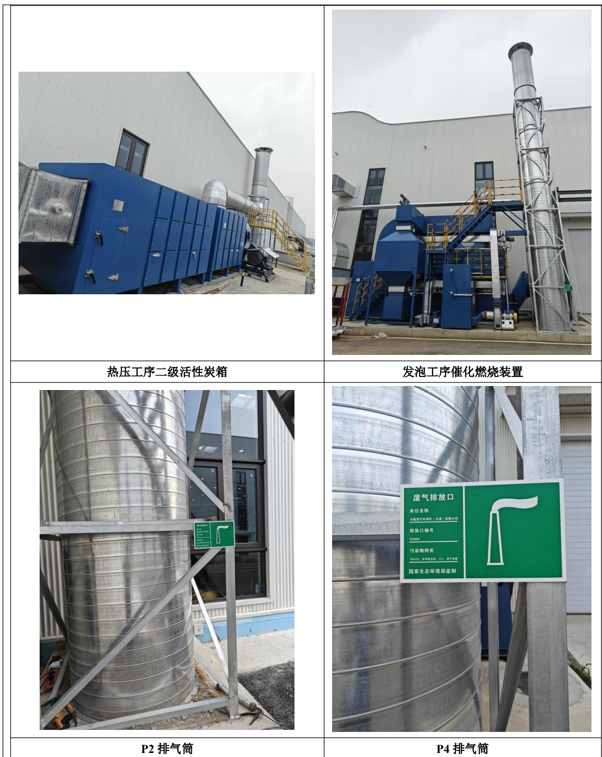
图 3-1 废气收集治理设施及排气筒
