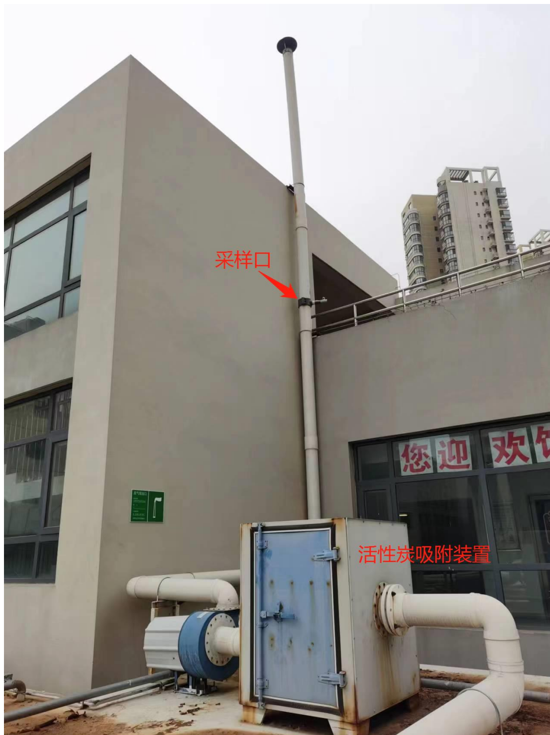
图 5-2 污水处理站活性炭和排气筒(P2)
