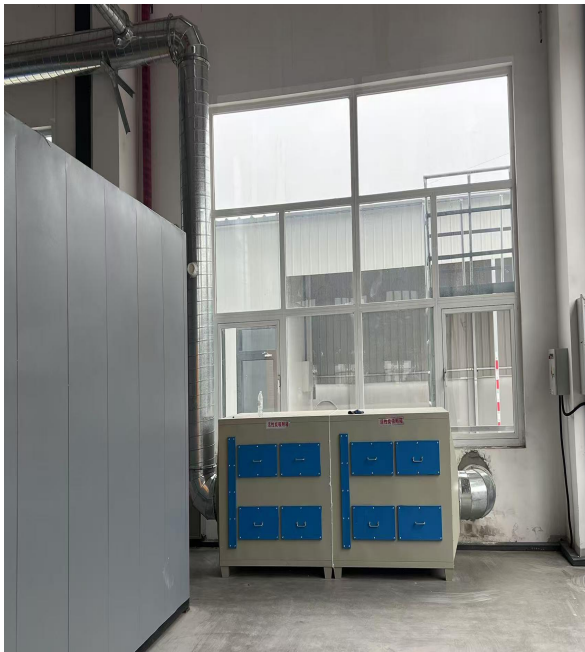
“UV 光氧+活性炭吸附” 废气治理设备
