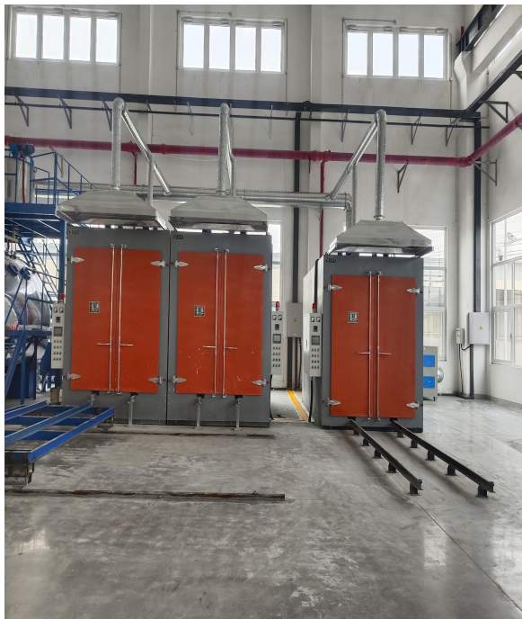
固化炉废气收集方式
