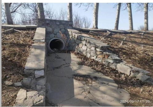
维修口门现状情况
