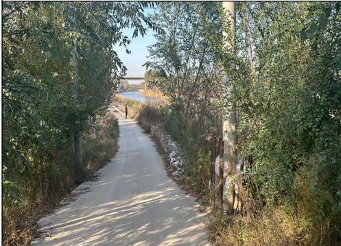
王庆坨排干倒虹吸至中亭堤涵闸现状堤防超高不足
