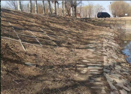
万达鸡场闸至津同公路段现状浆砌石结构砂浆已脱落
