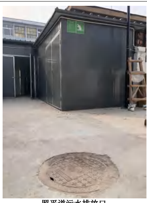
罗平道污水排放口
