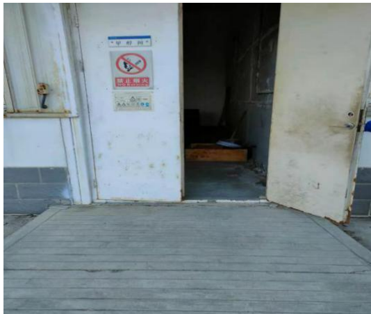
甲醇库门口围堰及缓坡
