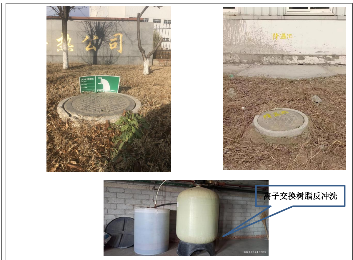
图 3-2 污水排放口及排污降温池
