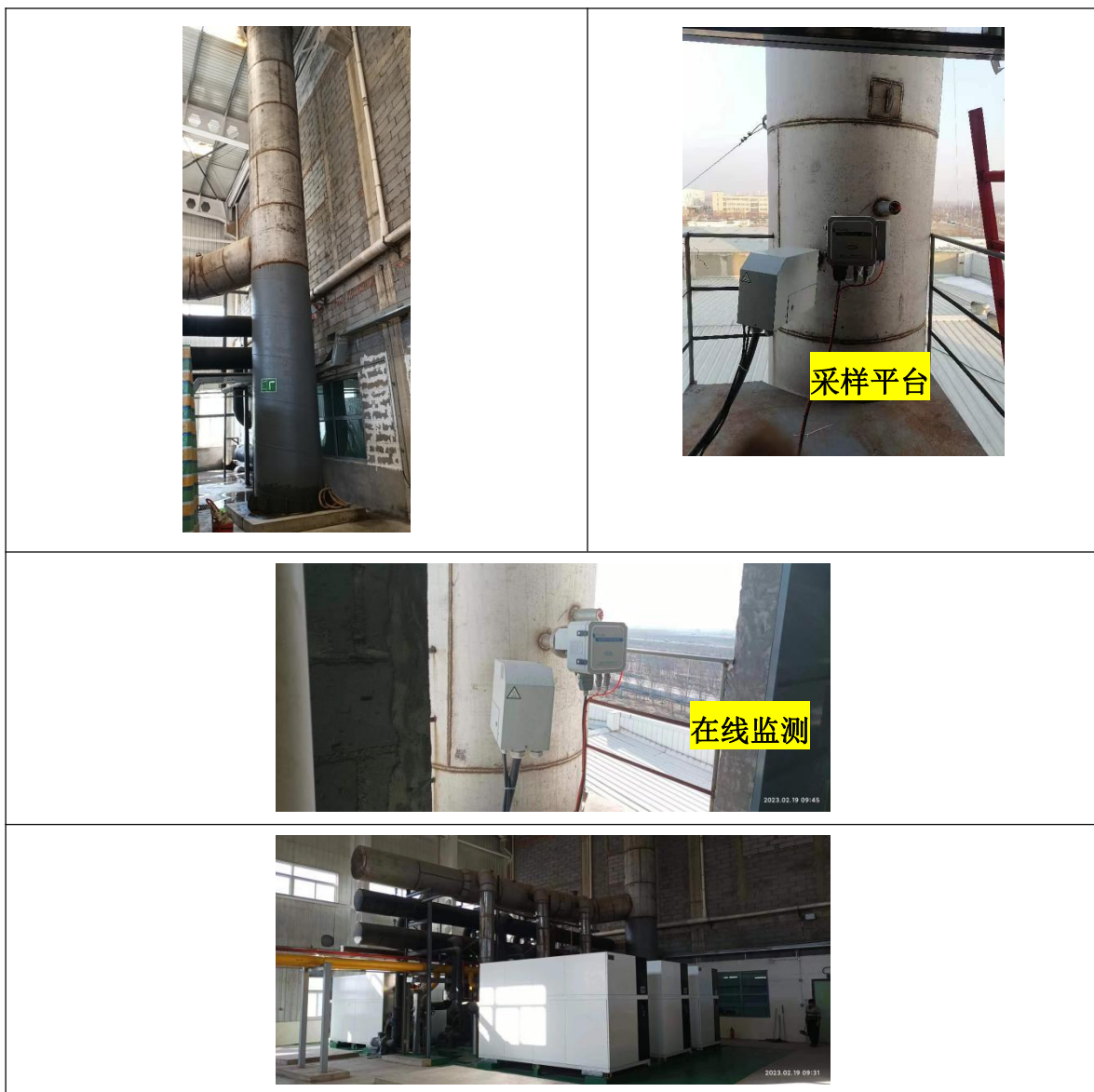
图 3-1 燃气锅炉排气筒 P1 及其在线监测
