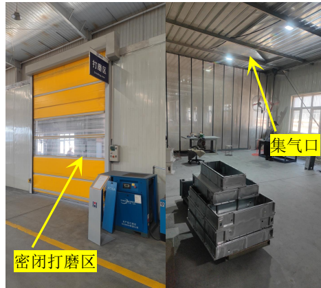
图 2-6 现有工程密闭打磨区及集气口
